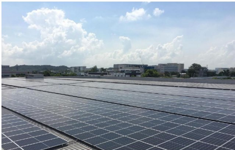
新たにPPAを導入したSEPの拠点
