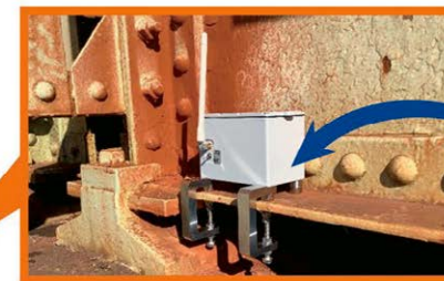
鉄道橋の鋼橋支点部に設置されている 「アオリ監視装置」
